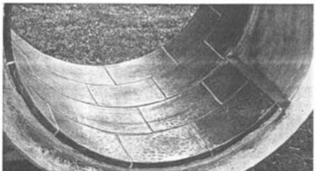
Rys. 9. Rura betonowa z wykładziną bazaltową. Wątpliwości wzbudza znaczna liczba fug oraz zastosowane wypełnienie – nie udało się uzyskać odpowiedzi na pytanie, jak się ono zachowa w warunkach podwyższonej agresywności środowiska
